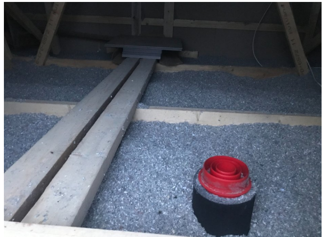
Radon-putkea ei olla yhdistetty katolle asti. Vesikatolta löytyy valmis läpivienti. Suosittelemme radon-mittausta ja sen tulosten perusteella putken yhdistämistä ja tarvittaessa radon-imurin asentamista
