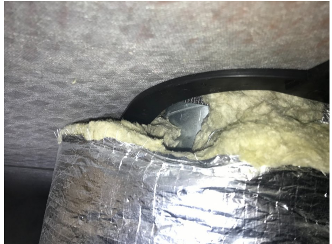
Iv-putken eristys ei yllä loppuun asti. Putken pinnalle voi kerääntyä kondensaivettä. Suosittelemme putken eritämistä.
